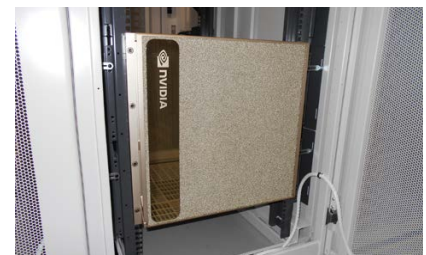
NVIDIA Tesla V100を16基搭載するNVIDIA DGX-2は、社外のデータセンターに設置されている
